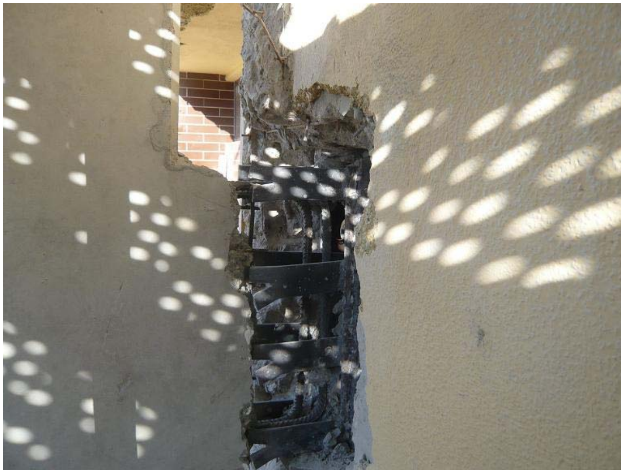
Detaily dílce po obnažení výztuže a kování.
