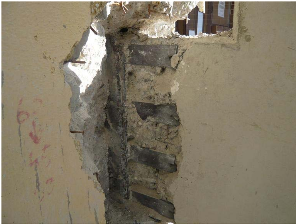
Následně odpadla krycí vrstva betonu.
